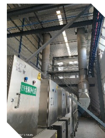
噴漆廢氣UV光解及高空排放
