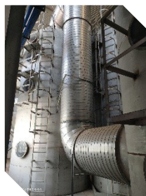
噴漆廢氣噴淋塔
