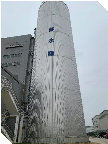
儲水罐－蓄冷／空調設備
