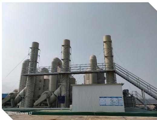
酸霧廢氣處理設施
